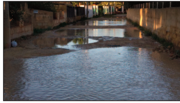
LA STRADA DISSESTATA
