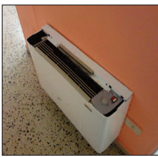
QUELLO CHE RESTA DEI TERMOSIFONI DELLA SCUOLA "MAZZINI"
