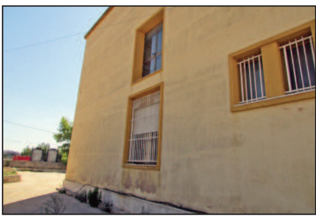
LA PARTE DELL'EDIFICIO DOVE MANCA LA SCALA D'EMERGENZA
