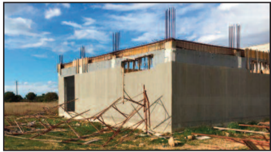
LA STRUTTURA DANNEGGIATA
